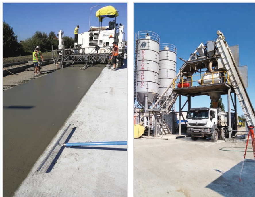
Собственные мощности по производству и укладке фибробетона в Калининграде и Калининградской области
